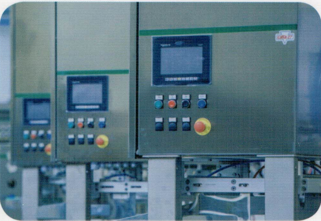
Gestione automatica con PLC PLC automatic management PLC otomatik yönetim
