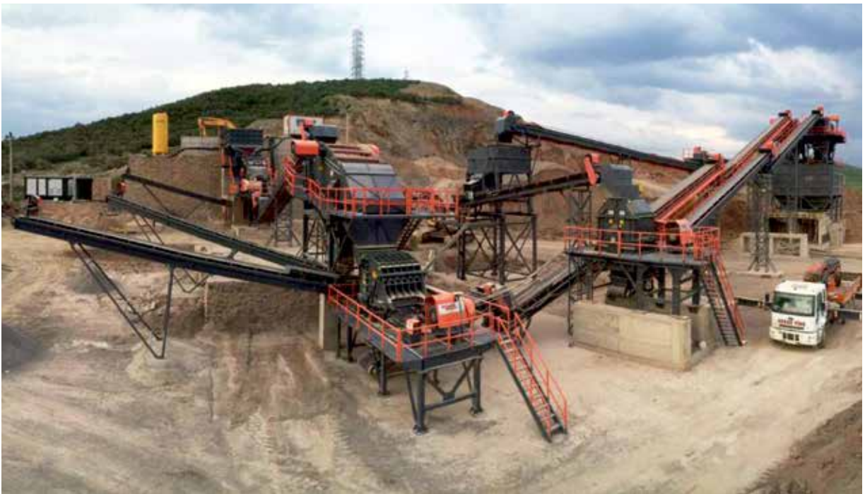
450-500 T/S Kapasiteli Kırma Eleme Tesisi – İstanbul - Dilovası 450-500 TPH Capacity Crushing Screening Plant - İstanbul - Dilovası
