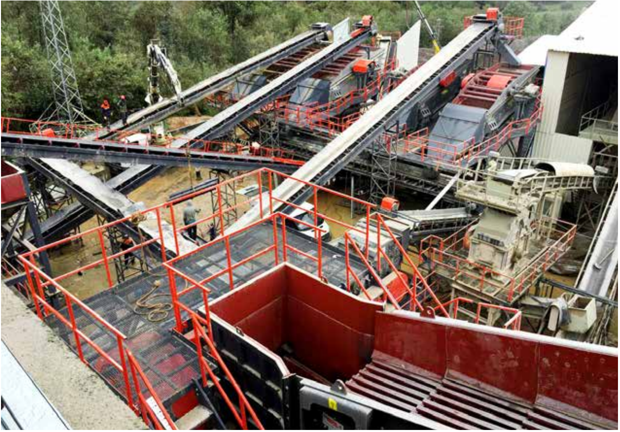
450-500 T/S Kapasiteli Kırma Eleme Tesisi – İstanbul - Dilovası 450-500 TPH Capacity Crushing Screening Plant - İstanbul - Dilovası
