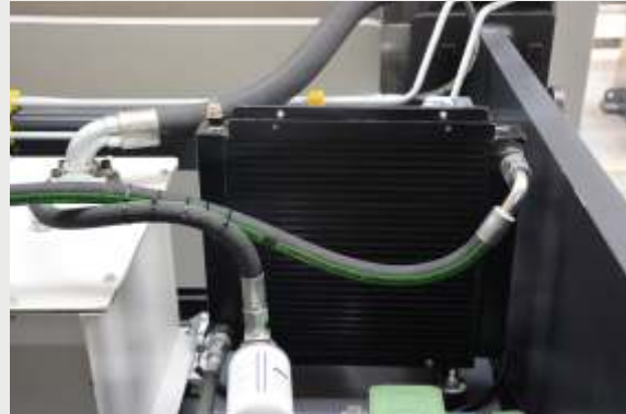
Hidrolik Yağ Soğutucu Sistemi
