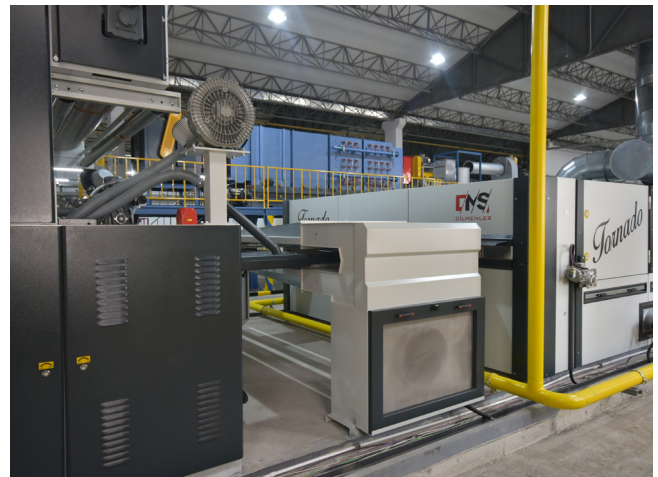
Hava Soğutma Fan Bölümü Exit Cooling Unit
