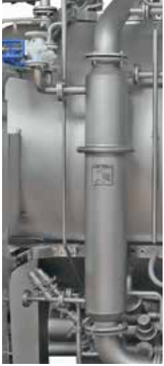
Ana tank ısıtma eşanjörü
