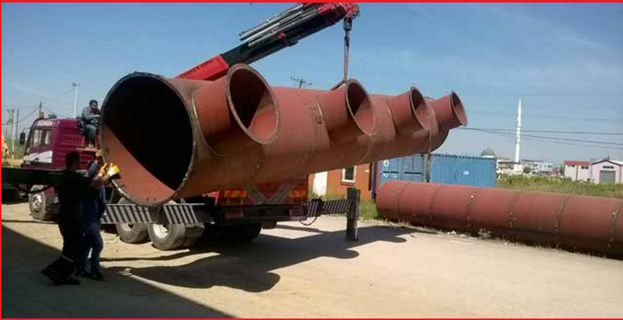
Demir Çelik Fabrikası Sıcak Gaz Borusu
