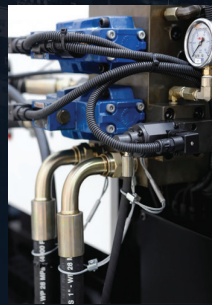
Valf Kontrol Ünitesi Valve Control Unit
