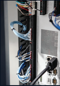
PLC Kontrol Ünitesi PLC Control Unit
