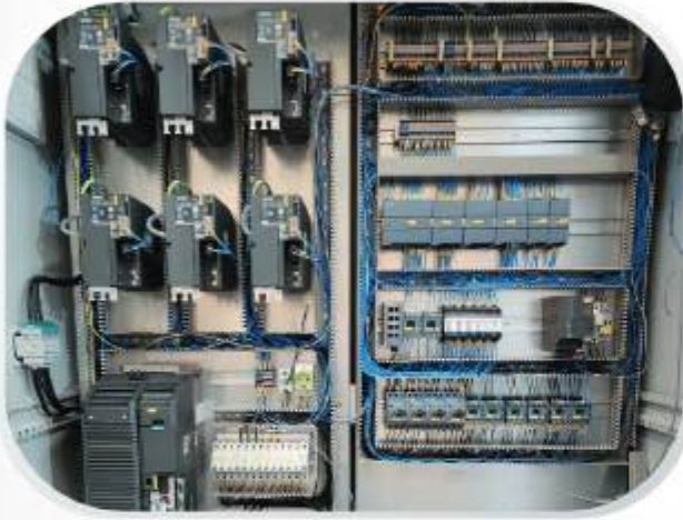
Siemens Elektrik Panosu
