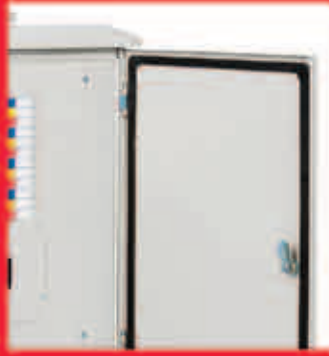
Elektrik panoları Electrical panels
